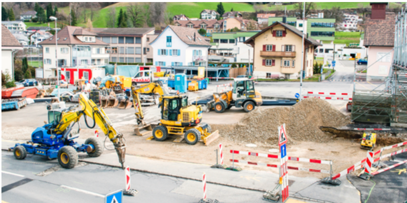
Entlebuch est en chantier: près de la place du marché, la route cantonale 10 est en cours d'assainissement.
