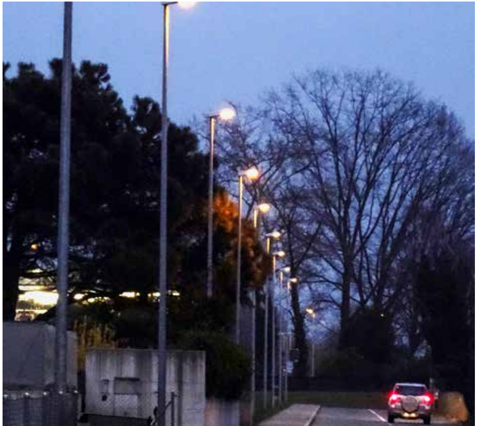
Eclairage public obsolète? Le programme ComuLux soutient les communes dans la modernisation.
