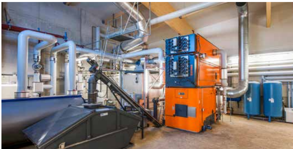
Vue de l'intérieur de la chaufferie. Photo: Eveline Perroud pour le bureau d'architecte Philippe Langel SA
