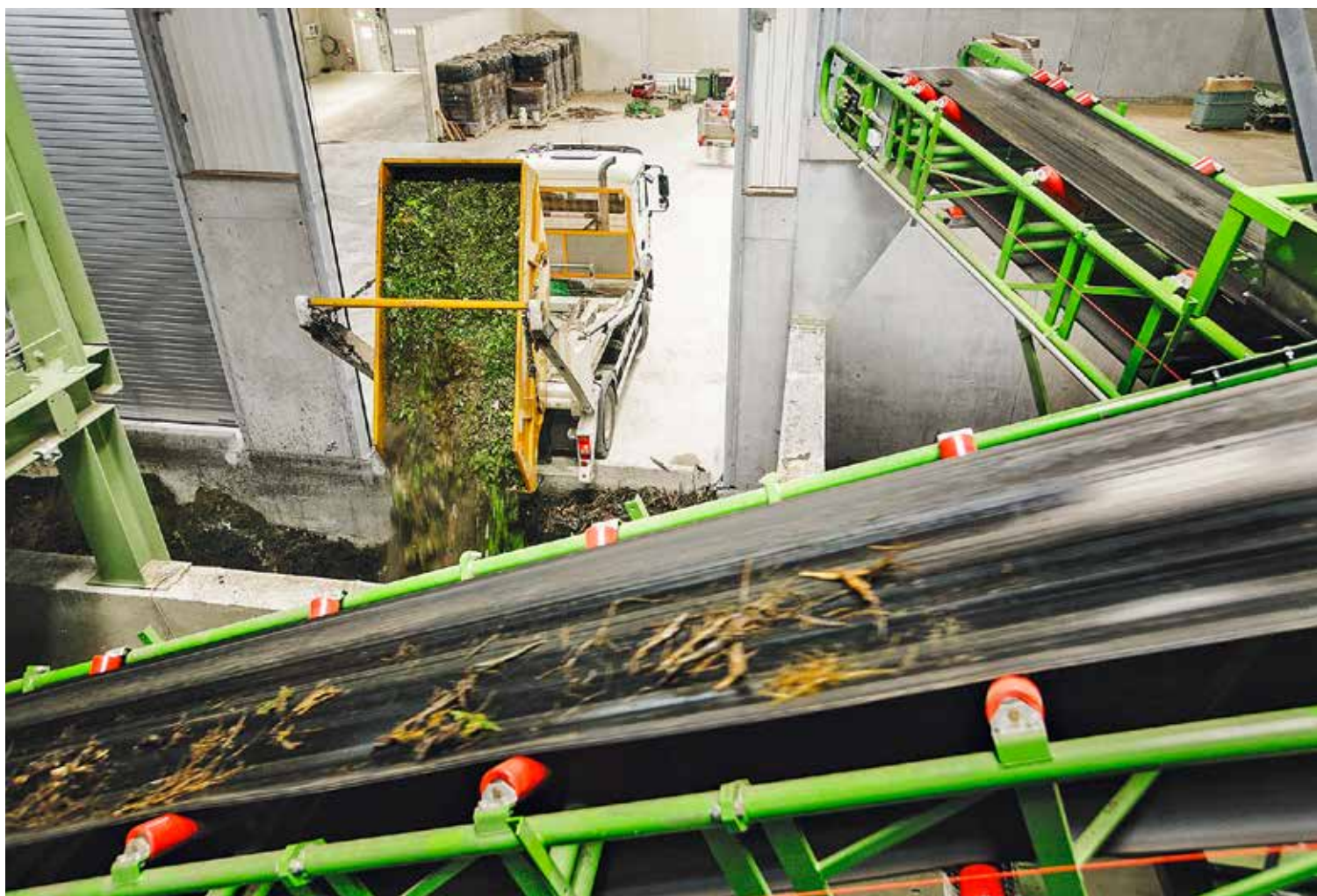
Les déchets biologiques collectés sont broyés, puis acheminés dans le fermenteur de biogaz. C'est là que se produit la transformation industrielle de la biomasse non ligneuse en biogaz.
