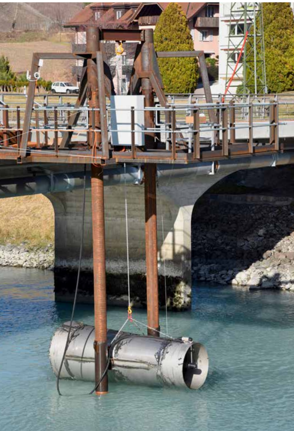
Le premier prototype d'une hydrolienne fluviale est installé dans le canal de fuite de la centrale hydroélectrique de Lavey (VD) pour une durée de six mois.
