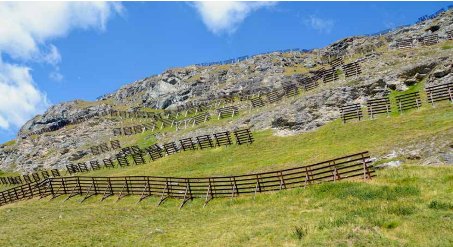
Stahlschneebrücken in einem Lawinenanbruchgebiet.
