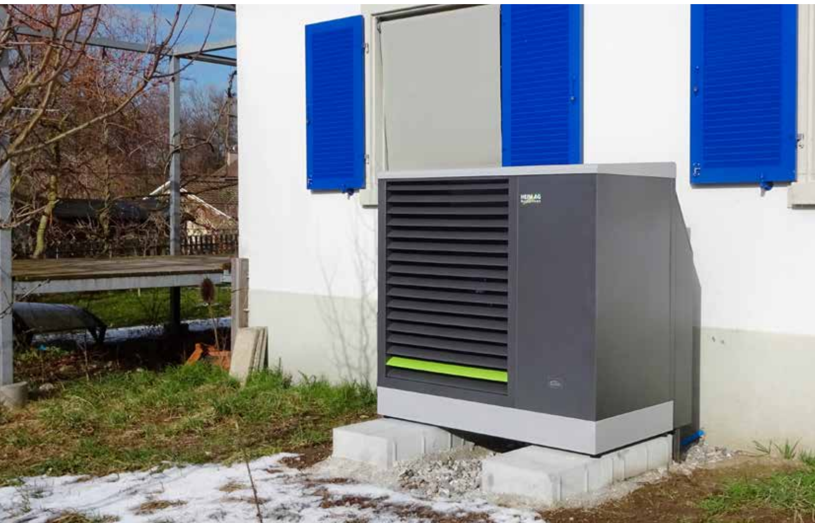
Moderne Wärmepumpen sind heute lärmarm.
