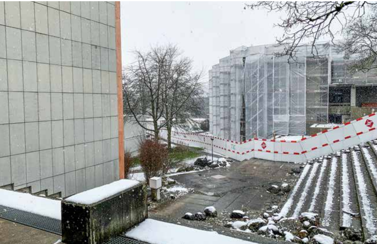
Die beiden Schultrakte A (rechts, eingerüstet) und B, dazwischen der Schulhof mit den zum Park führenden Treppen.
