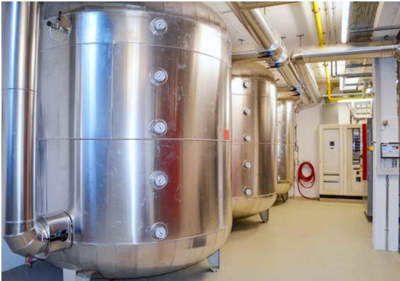
Die Wärme-Kraft-Kopplung-Anlage «Rione Madonnetta» im Quartier Molino Nuovo.
