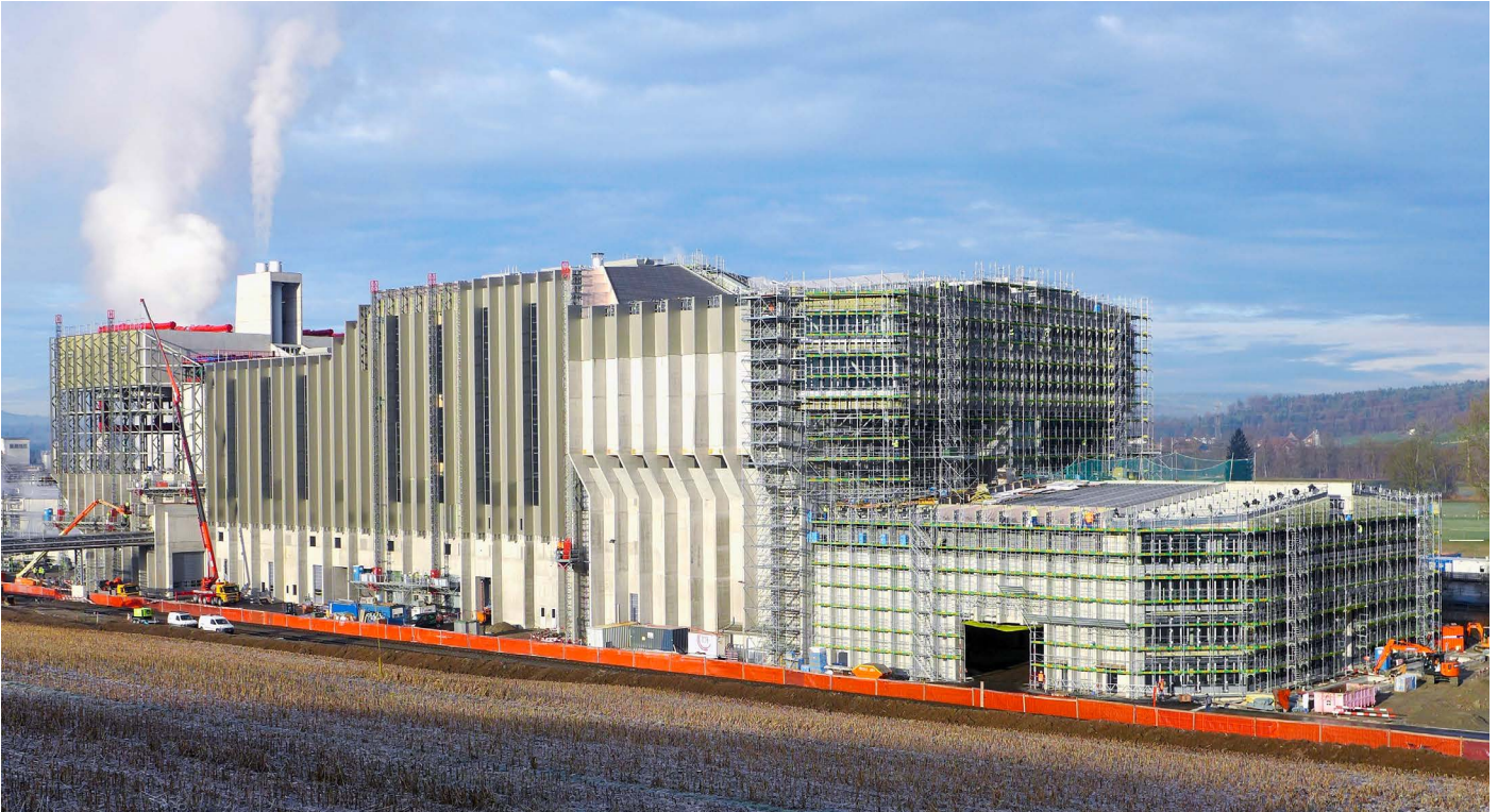
Die KVA «Renergia» liefert Abwärme an die Papierfabrik Perlen, die Energieeffizienz ist hoch. Das Werk ist ein gemeinsames Projekt der Kehrrechtverbände der Zentralschweiz und der Perlen Papier AG.
