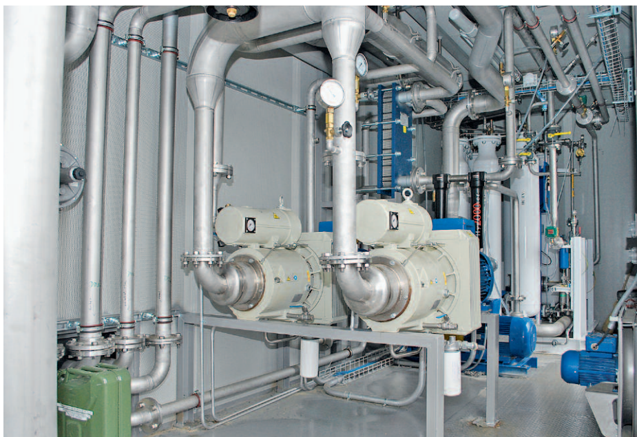
Vue de l'unité d'épuration du biogaz de l'usine Germanier à Lavigny.
