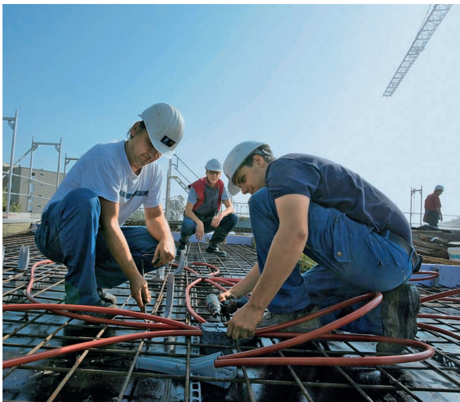
Une phase de chantier traditionnel: ici les spécialistes assemblent des tuyaux porteurs de flux. (Photos: Suva)
