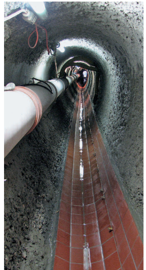
Blick in den 760 m langen Kanal in Winterthur, der zurzeit saniert wird.
