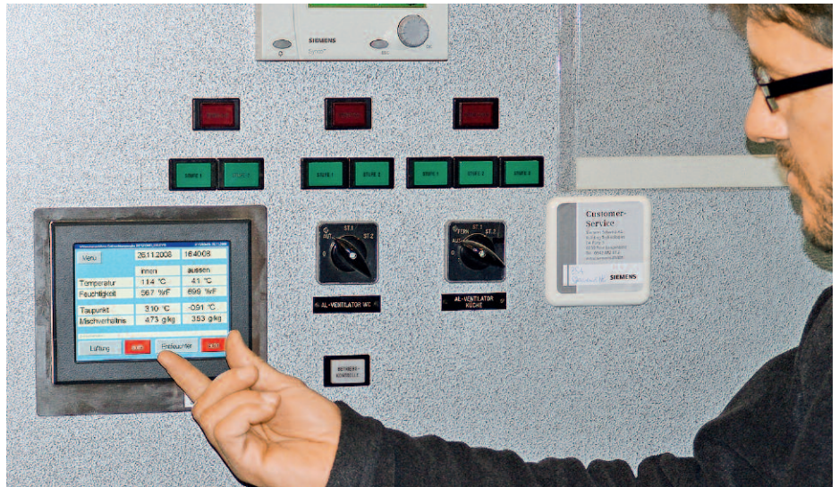
Die Zentraleinheit im Schaltschrank Zivilschutzanlage Steinmättli Stans.
