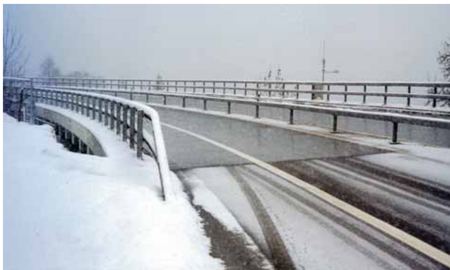
Auf einer Nationalstrassenbrücke bei Därligen am Thunersee wurde bereits 1994 das Serso-Pilotprojekt verwirklicht: Sonnenenergie-Rückgewinnung aus der Strassenoberfläche und Energiespeicherung im Felsen. (Bilder: Polydynamics Engineering)
