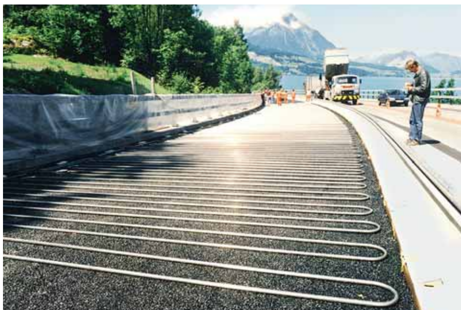
In der Fahrbahn verlegte Rohrschlaufen dienen im Winter der Oberflächentemperierung.
