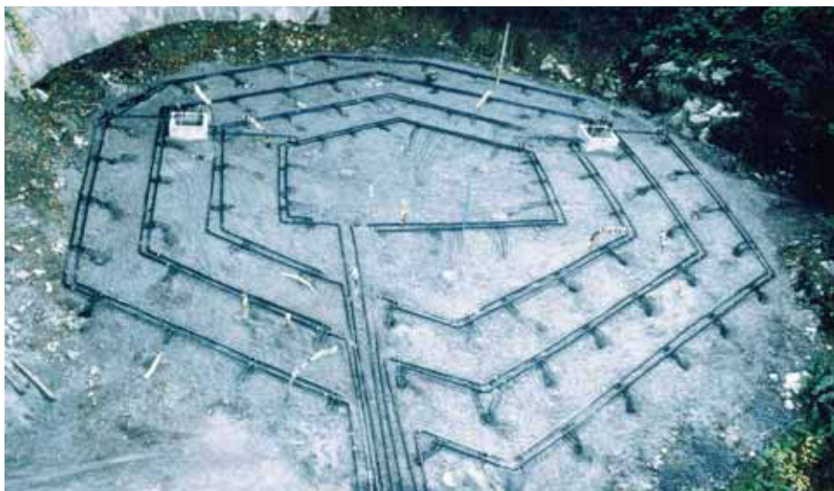
Der 55 000 Kubikmeter umfassende und thermisch isolierte Felsspeicher nimmt die sommerliche Wärme auf und gibt sie im Winter zur Fahrbahntemperierung ab.
